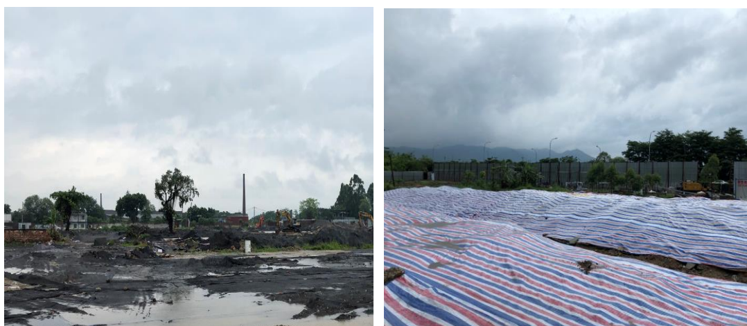
基坑开挖区域黑色防尘网覆盖 土壤养护区域底部 HDPE 膜防渗、彩条布防雨
